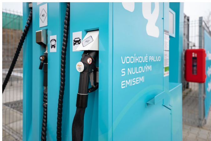
Obr. 33 První veřejná samoobslužná vodíková stanice ORLEN Benzina
